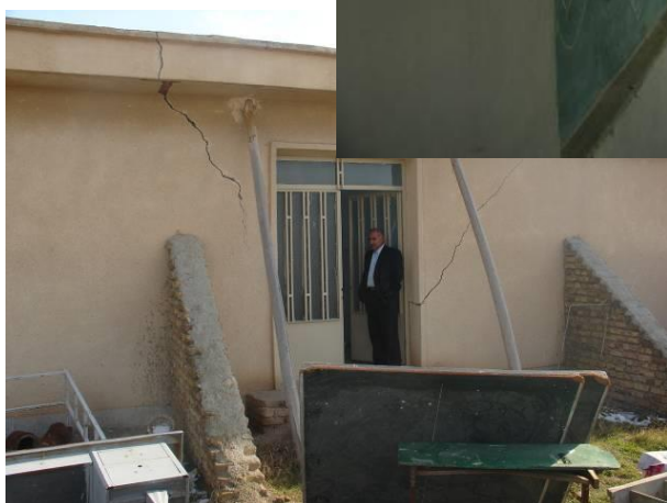
شکل ۸- اثر فرونشست بر ساختمان‌ها
